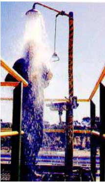
图 9-1 紧急冲淋装置
